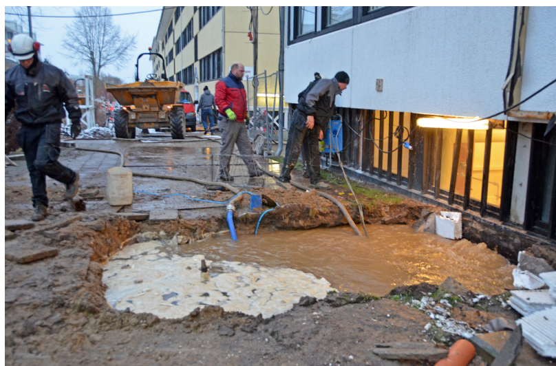
Brud på hovedvandledning ved Sporegangen januar 2014.
